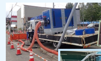
胆振東部地震による液状化現場
