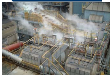
水砕スラグ製造設備
